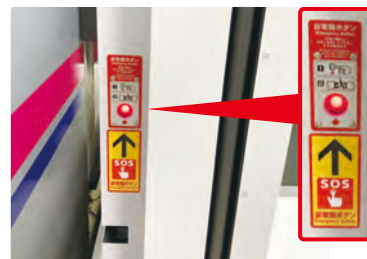
ホームドア非常開ボタン
