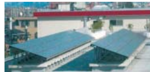
高幡不動車両基地の太陽光発電システム
