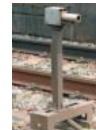
踏切障害物検知装置
