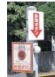
踏切支障報知装置
