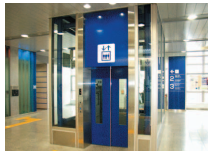
エレベーター
