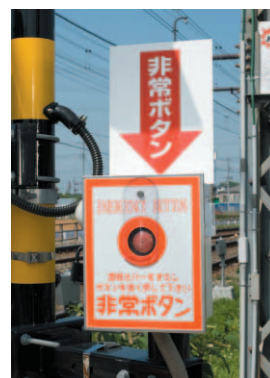
踏切支障報知装置
