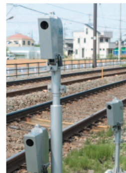
踏切障害物検知装置
