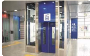
エレベーター
