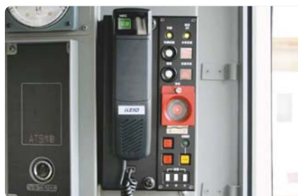
防護無線装置
