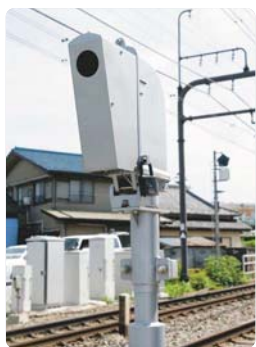
踏切障害物検知装置
