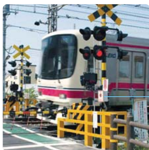
踏切支障報知装置
