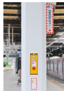
列車非常停止ボタン
