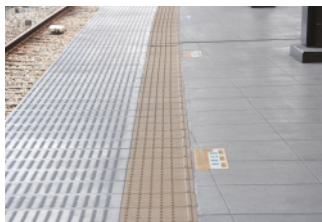
内方線付き点状ブロック
