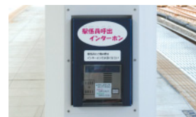
駅係員呼出インターホン
