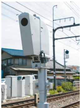
踏切障害物検知装置
