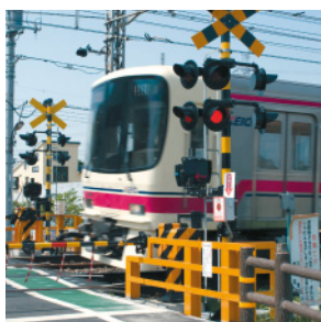
踏切支障報知装置
