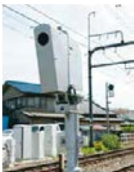
踏切障害物検知装置
