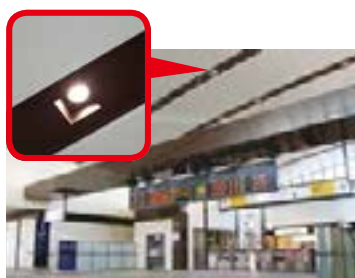
駅構内のLED照明
