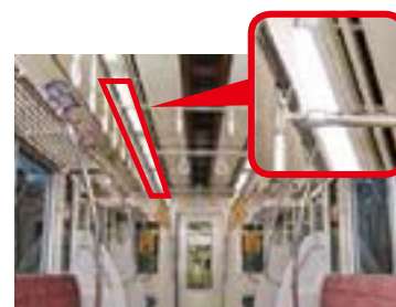
電車内のLED照明
