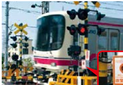
踏切支障報知装置 (非常ボタン)
