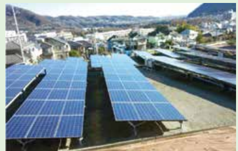
神奈川県相模原市の太陽光発電システム
