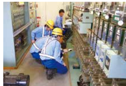
機器室での 障害復旧訓練
