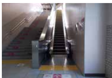
京王堀之内駅 エスカレーター
