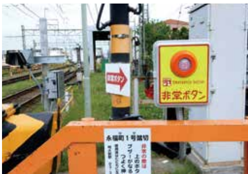
踏切支障報知装置 (非常ボタン)
