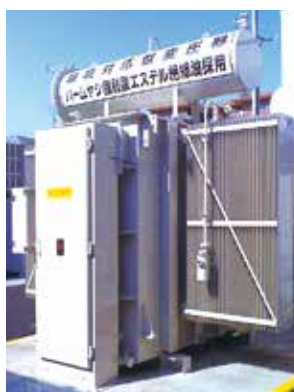
上北沢変電所
