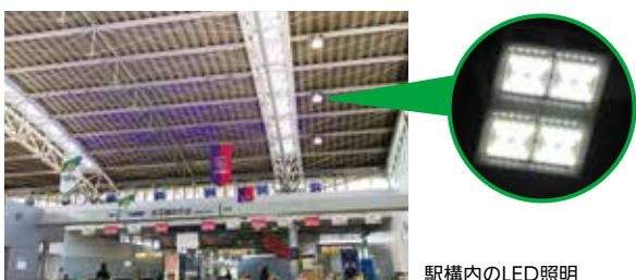
駅構内のLED照明
