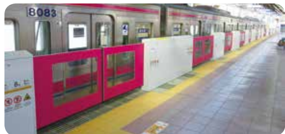
飛田給駅に設置されたホームドア
