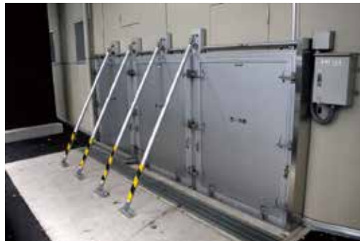
変電所の止水板
