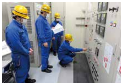
変電所の点検
