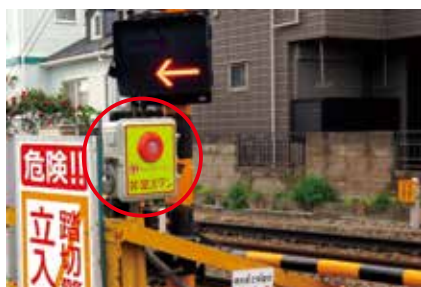
踏切支障報知装置 (非常ボタン)
