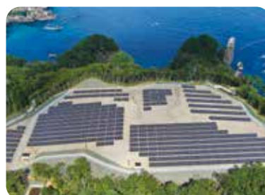
岩手県宮古市の太陽光発電システム
