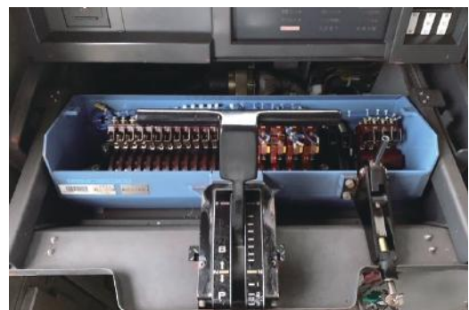
主幹制御器内部
