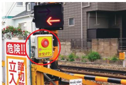
踏切支障報知装置(非常ボタン)
