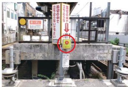
踏切内の踏切支障報知装置(非常ボタン)
