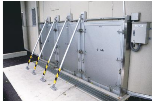
変電所の止水板
