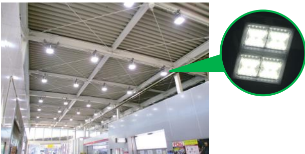
駅構内のLED照明
