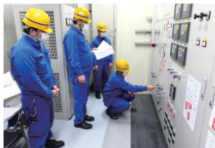
変電所の点検
