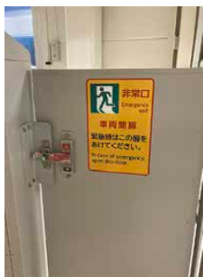
ホームドア車両間扉
