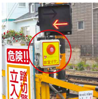
踏切支障報知装置 (非常ボタン)
