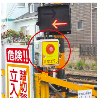
踏切支障報知装置 (非常ボタン)
