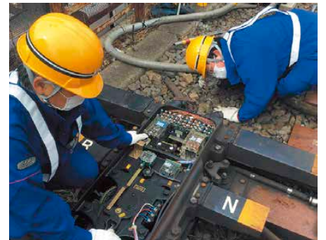
転てつ機の点検
