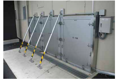
変電所の止水板
