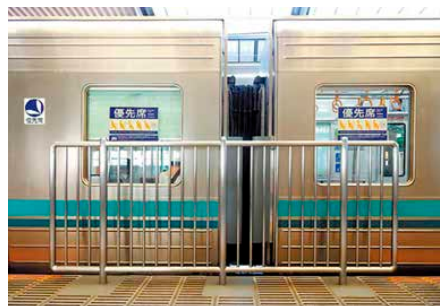
転落防止固定柵
