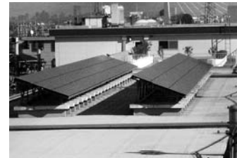
高幡不動産車両基地の太陽光発電システム
