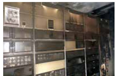
火災直後の変電所内部
