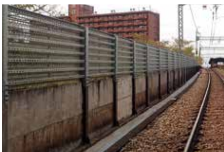
防風柵 (高井戸駅～富士見ヶ丘駅間)
