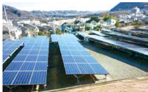
神奈川県相模原市の太陽光発電システム
