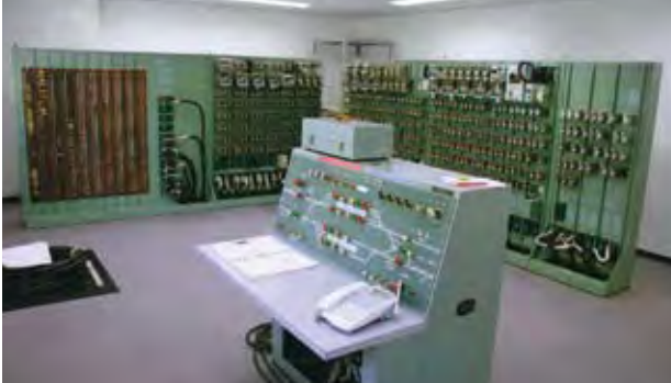
電気係員連動訓練室
