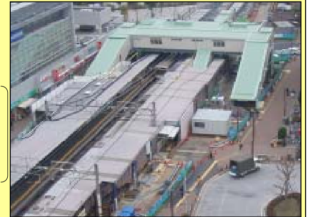
調布駅付近連続立体交差事業 (仮橋上駅舎に切替えた国領駅)
