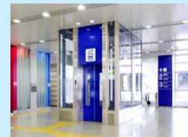
エレベーター
