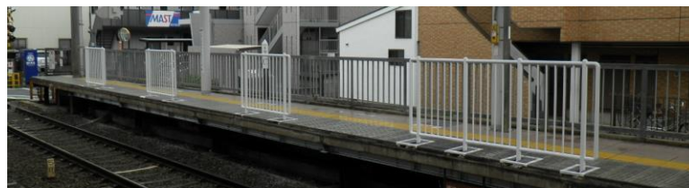
《転落防止固定柵（設置例：飛田給駅）》
