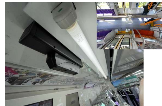
リアルタイム伝送機能付き 車内防犯カメラの設置 (2022年度 656/877両 完了)
