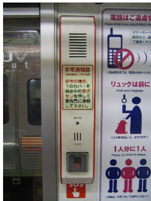
車内非常通報装置 （双方向対話式）
