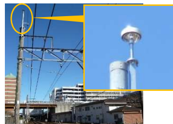
雷害対策（避雷針の設置）
