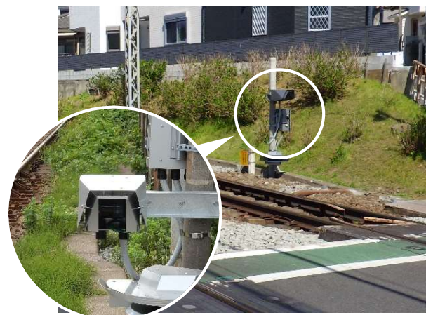
二次元式踏切障害物検知装置
