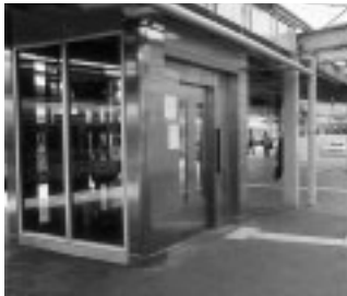
駅構内に設置したエレベーター
