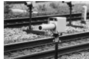
踏切障害物検知装置
