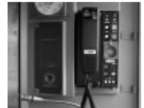
防護無線装置
