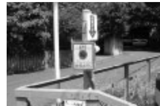
踏切支障報知装置
