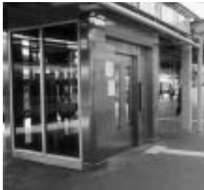
駅構内に設置したエレベーター
