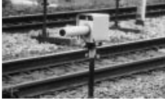
踏切障害物検知装置
