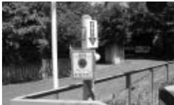
踏切支障報知装置
