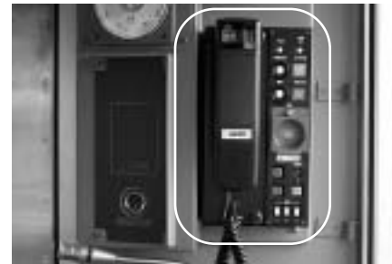
防護無線装置
