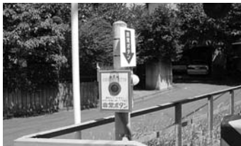
踏切支障報知装置
