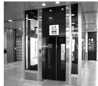
駅構内に設置したエレベーター
