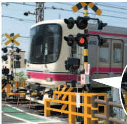
踏切支障報知装置
