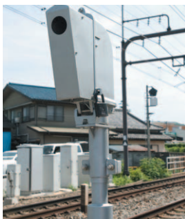
踏切障害物検知装置
