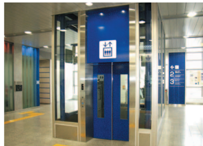
エレベーター
