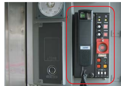
防護無線装置
