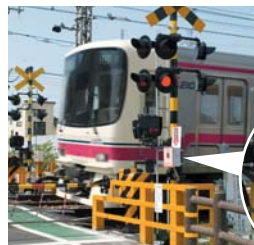
踏切支障報知装置
