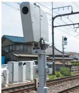
踏切障害物検知装置
