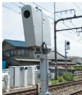
踏切障害物検知装置
