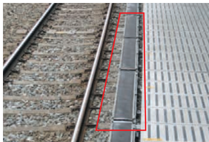
転落検知装置
