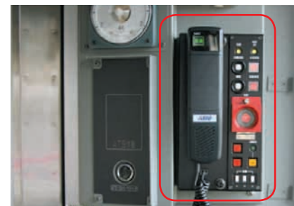
防護無線装置
