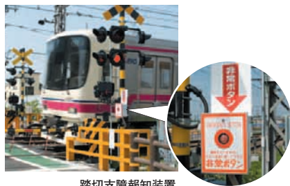
踏切支障報知装置
