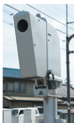
踏切障害物検知装置
