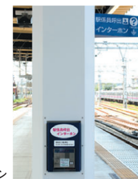
駅係員呼出インターホン
