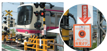
踏切支障報知装置（非常ボタン）
