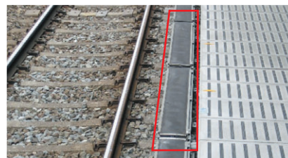
転落検知装置
