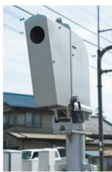
踏切障害物検知装置
