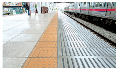
内方線付き点状ブロック
