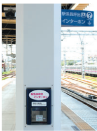
駅係員呼出 インターホン
