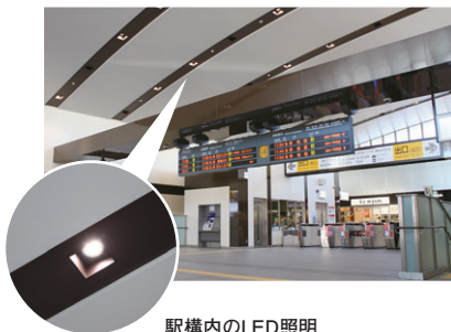
駅構内のLED照明
