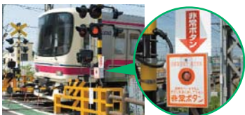
踏切支障報知装置（非常ボタン）
