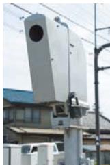
踏切障害物検知装置
