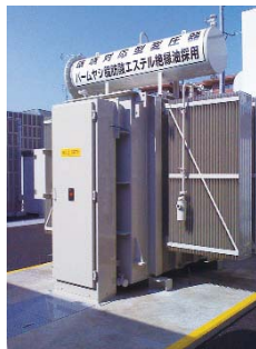
環境配慮型の変圧器
