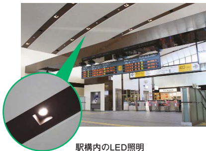
駅構内のLED照明
