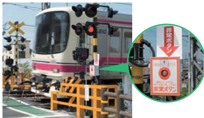
踏切支障報知装置(非常ボタン)
