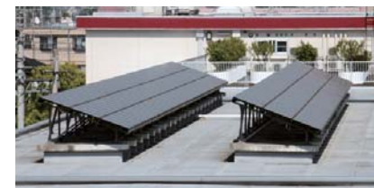
太陽光発電システム
