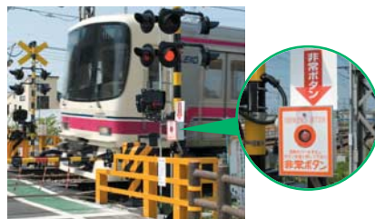
踏切支障報知装置(非常ボタン)
