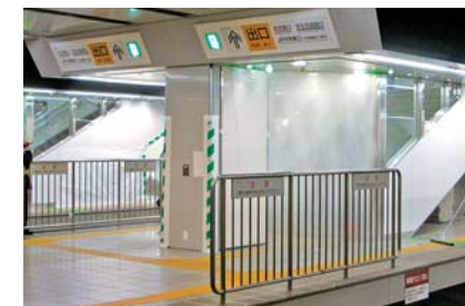
幡ヶ谷駅の避難通路(上) 新宿駅のウォータースクリーン防火区画(下)
