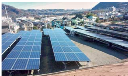
相模原市での発電設備
