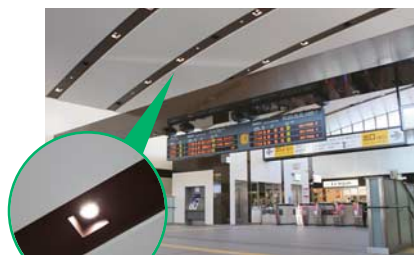
駅構内のLED照明
