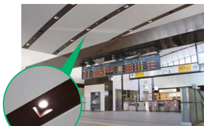
駅構内のLED照明
