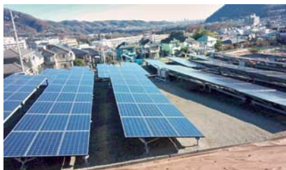
相模原市の発電設備
