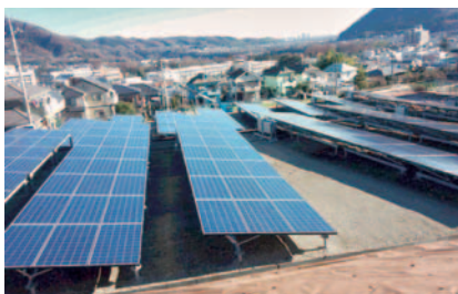
相模原市の発電設備
