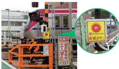
踏切支障報知装置(非常ボタン)
