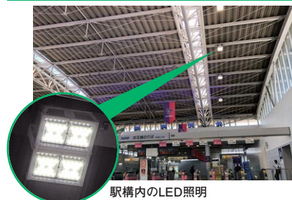
駅構内のLED照明
