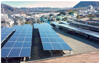
相模原市の発電設備
